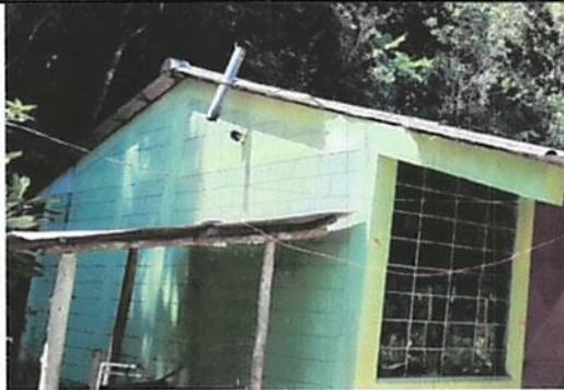
FOTO 5: VIDRIOS QUEBRADOS Y CHIMENEA INSERVIBLE
