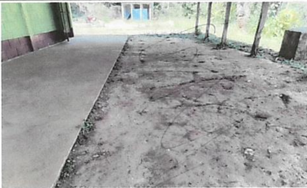
FOTO 1: FALTA COMPLETAR AREA DE PISO DE CONCRETO
