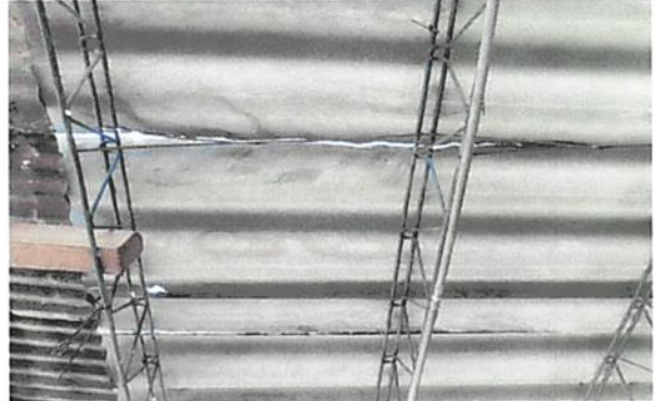
FOTO 2: NECESIDAD DE CAMBIAR ESTRUCTURA (EN PARTES DE MADERA) Y LA LÁMINA SE ENCUENTRA EN MAL ESTADO (QUEBRADA)
