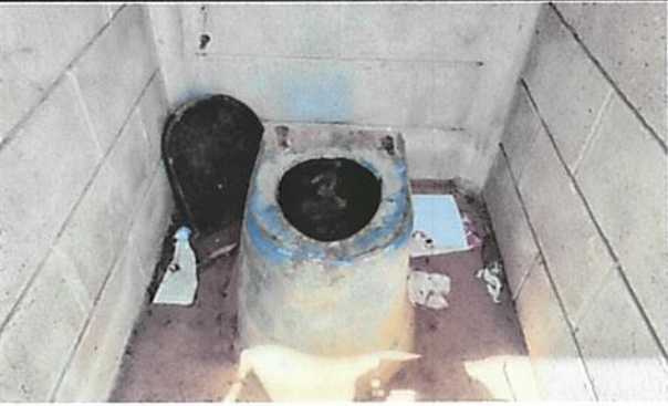
FOTO 3: LETRINAS INSERVIBLES, NECESIDAD DE CAMBIAR A INODORO LAVABLE POR RAZONES HIGIÉNICAS
