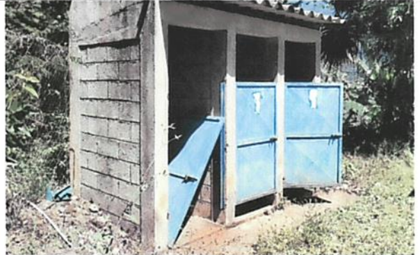
FOTO 4: PUERTAS DE LETRINAS EN MAL ESTADO, DESPRENDIDAS Y CON PASADOR DETERIORADO, NECESITAN REPARACIÓN
